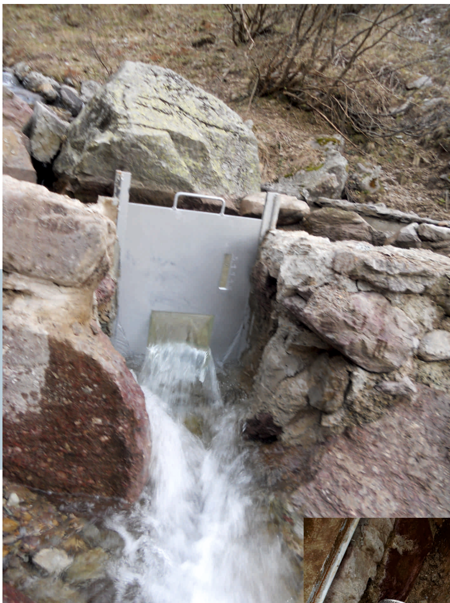
Particolare della paratoia con foro per rilascio del deflusso minimo vitale e livello graduato per la lettura della portata rilasciata.
