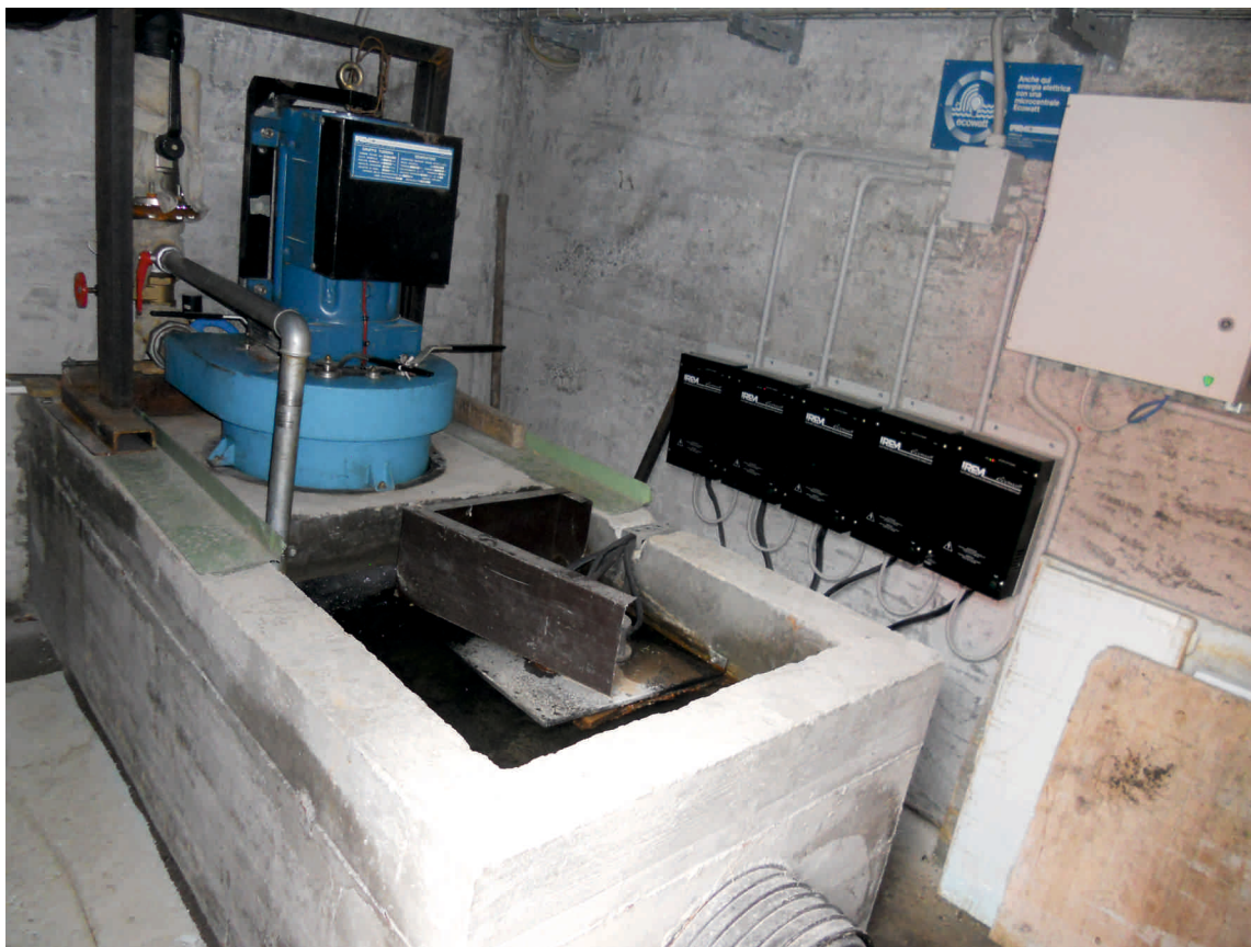
la sala macchine con la piccola turbina IREM ad asse verticale e la regolazione della potenza con semplici valvole manuali
