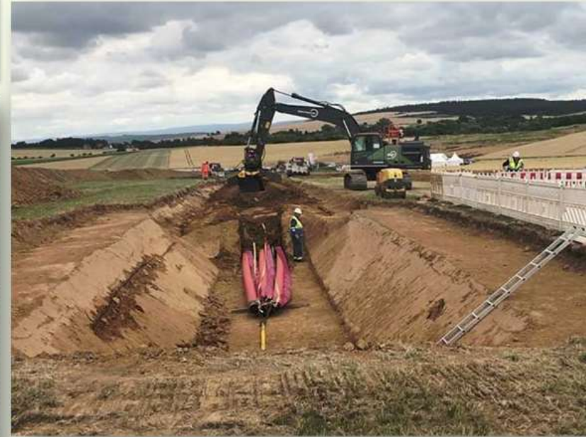
CAVIDOTTO PER L'ALTA TENSIONE IN GERMANIA
